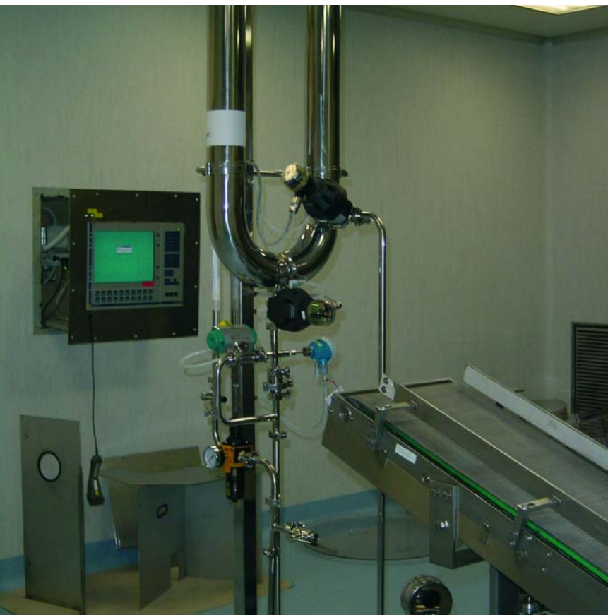
▲ User Point Loop WFI coibentato tubo nel tubo completo di valvole pneumatiche e strumentazione per il controllo durante le fase di prelievo e sterilizzazione WFI User Point Loop insulated tube in tube equipped with pneumatic valves and instrumentation for the control during the collection and sterilization phase.
