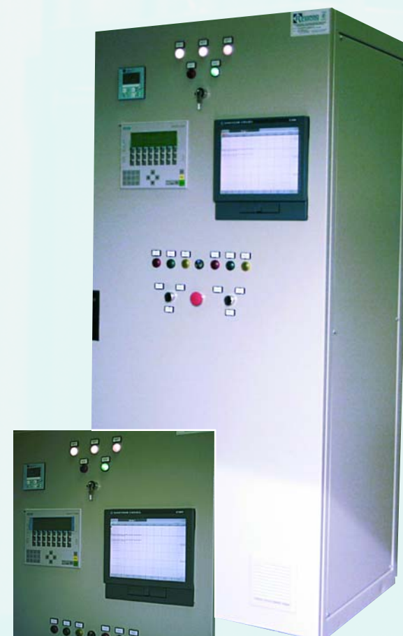
▲ Quadro di controllo Control board
